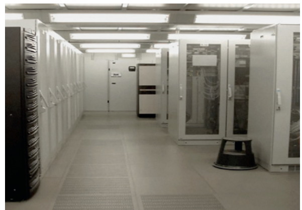
IngDiBa: Rechenzentrum für 800 User
